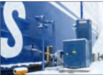
2008 Two MOOREX® 60T ashore mooring units Vuosaari Port, Finland Vuosaari Port
